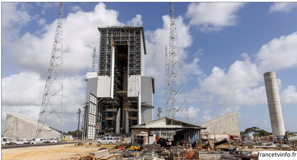
Le portique mobile
